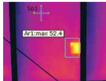
Värmebilden visar en varmgång som beror på en brusten cell i en 60-cells standardmodul.
