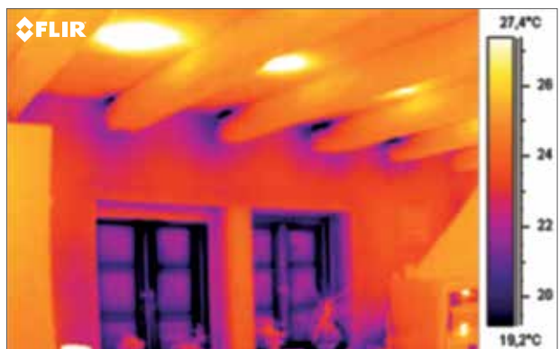
Värmebilden visar en köldbrygga mellan takbjälkarna och anslutningen i väggen.
